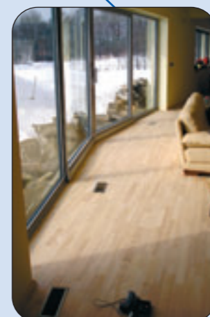
Prívod topného a větracího vzduchu u prosklené stěny
