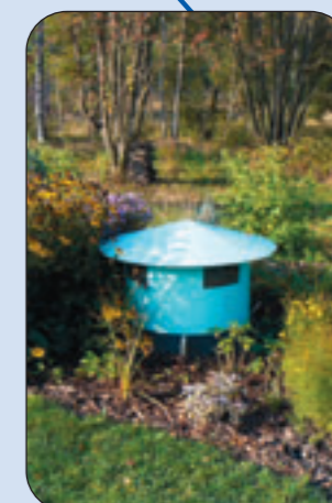
Kryt zemního výměníku tepla
