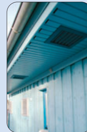
Nasávací a výfuková žaluzie v pohledu střechy
